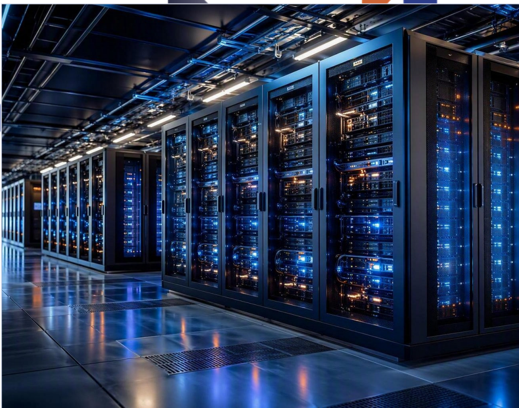
Capacità IT in colocation: infrastruttura fisica e continuità energetica
